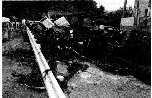
4. 自動車、材木などがひっかかった上道の尾橋
